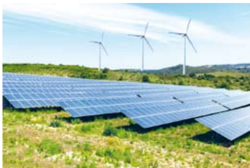
Рис. 38. Солнечные панели и ветроэнергетические установки
